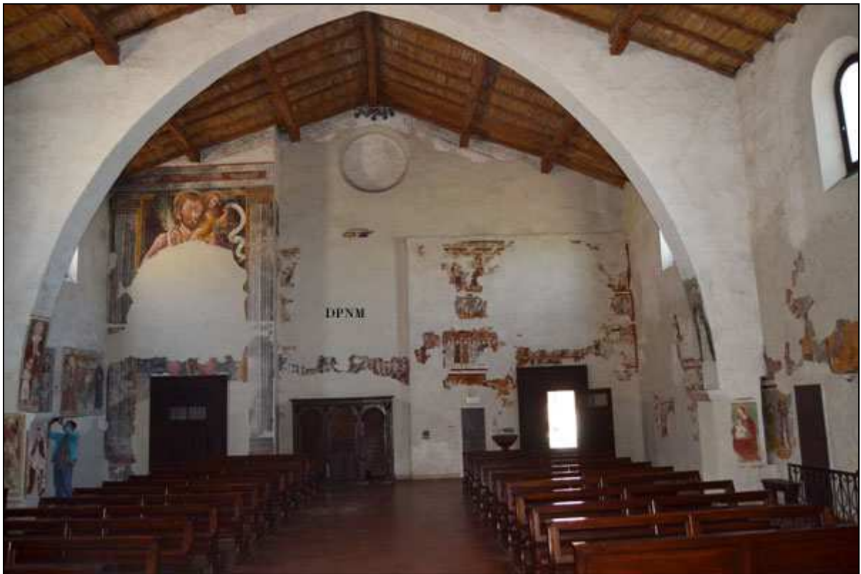
La controfacciata della chiesa con gli affreschi scoperti tra il 2002-2004. Si noti anche il rosone tamponato.
